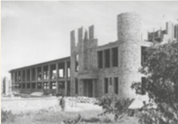
L'école des filles, ici en cours de construction, fut occupée par les soldats allemands. Elle fait aujourd'hui partie du groupe scolaire Jean Jaurès.
